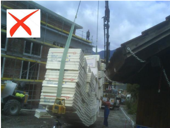
Tipo de fixação proibido. Risco de queda da carga
