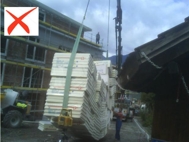
Verbotene Anschlagart. Gefahr für Lastabsturz
